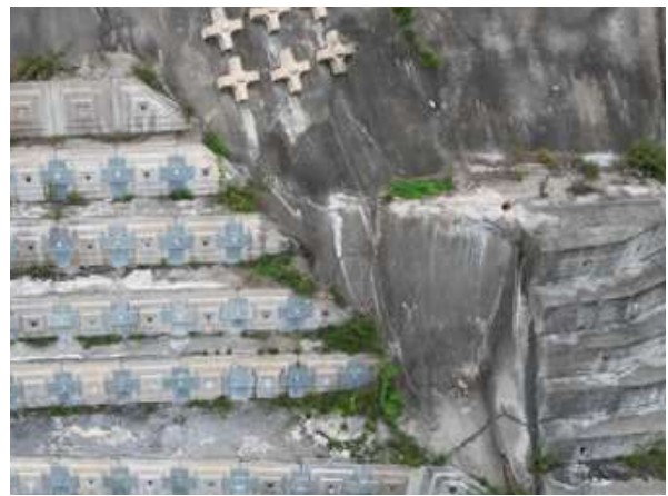
주변영향인자(절토사면부, 배수시설) 숯크리트 파손
