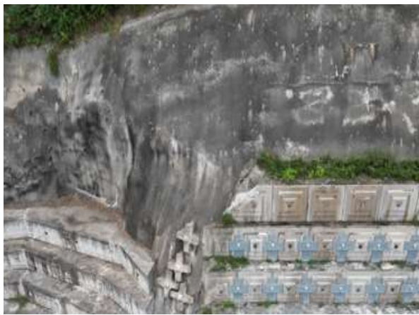
주변영향인자(절토사면부, 배수시설) 숯크리트 파손
