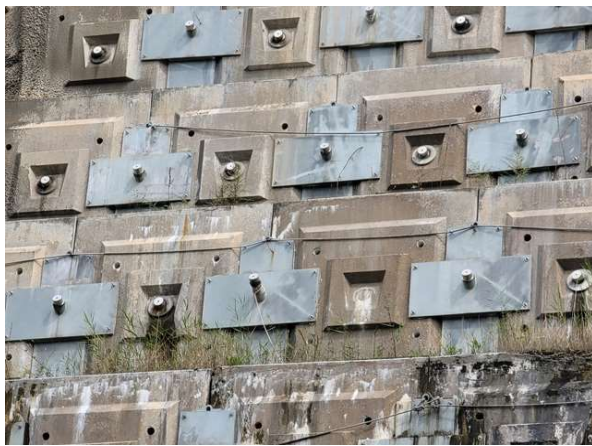
망상균열 및 백태
