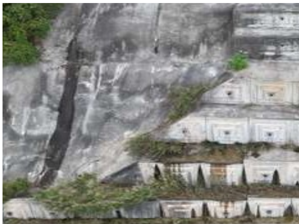
주변영향인자(절토사면부, 배수시설) 숯크리트 내부 토사유실
