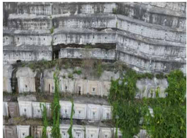
주변영향인자(절토사면부, 배수시설) 숯크리트 파손
